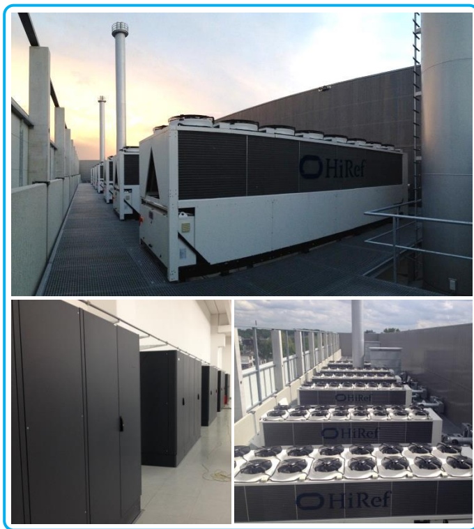
Rechenzentrum Frankfurt a.M.
